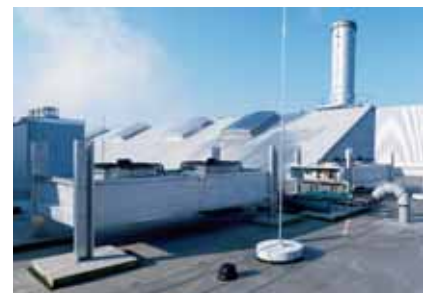
Isolierter Blitzschutz an Dachaufbauten
