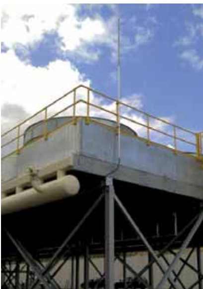
Isoliertes Ableitungssystem im explosionsgefährdeten Bereich
