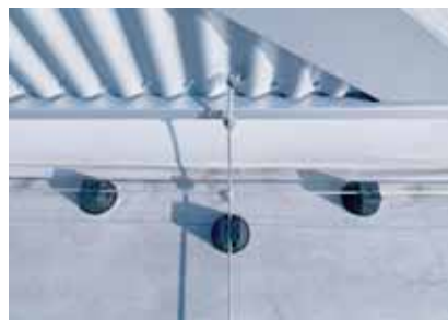
Anschluss der Metallfassade an das Blitzschutzsystem
