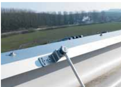
Anschluss der Attika an das Blitzschutzsystem
