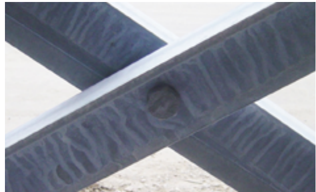
Leichter Weißrost an einer feuerverzinkten Konstruktion (Quelle: Institut Feuerverzinken)
