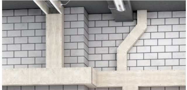
Montierter Brandschutzkanal an Wand und Decke
