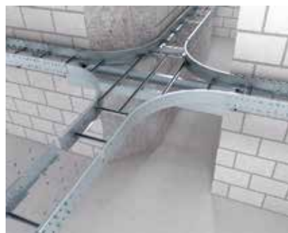
Montage Kreuzung Kreuzung in Kombination mit Weitspannkabelleiter. Die Kreuzung wird mit Außenverbindern mit der Weitspannkabelleiter verbunden.
