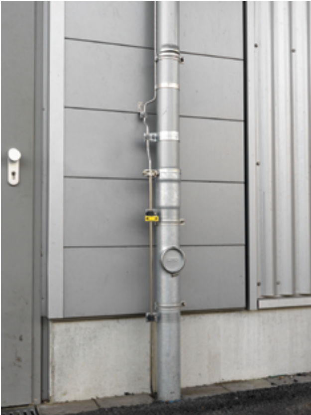
Blitzschutzableitung an einem Regenfallrohr
