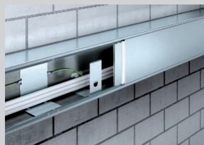
Versatz zwischen Kanalwanne und Kanaldeckel.
