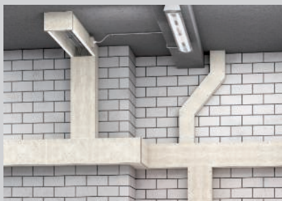
Montierter Brandschutzkanal an Wand und Decke
